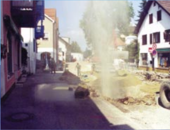
Wasserrohrbruch bei Straßen- bauarbeiten
