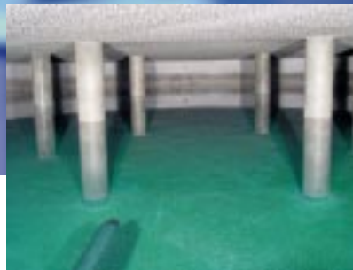
Hochbehälter Dießen St. Georgen gefüllt
