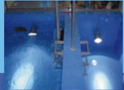
Sandfangbecken im Quellhaus
