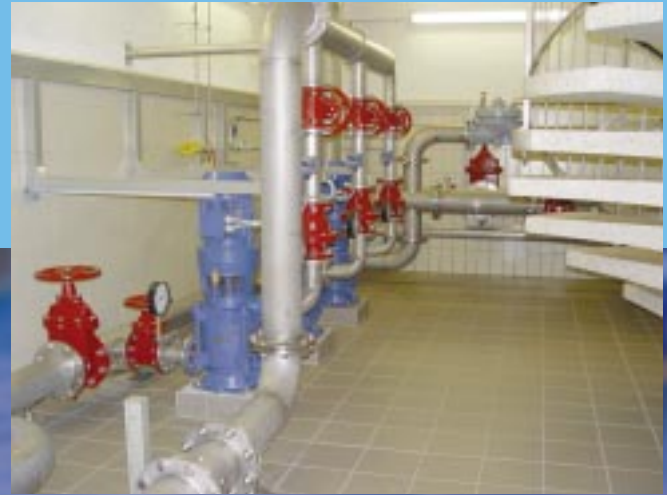
Hochbehälter Pitzeshofen Druckerhö- hungsanlage
