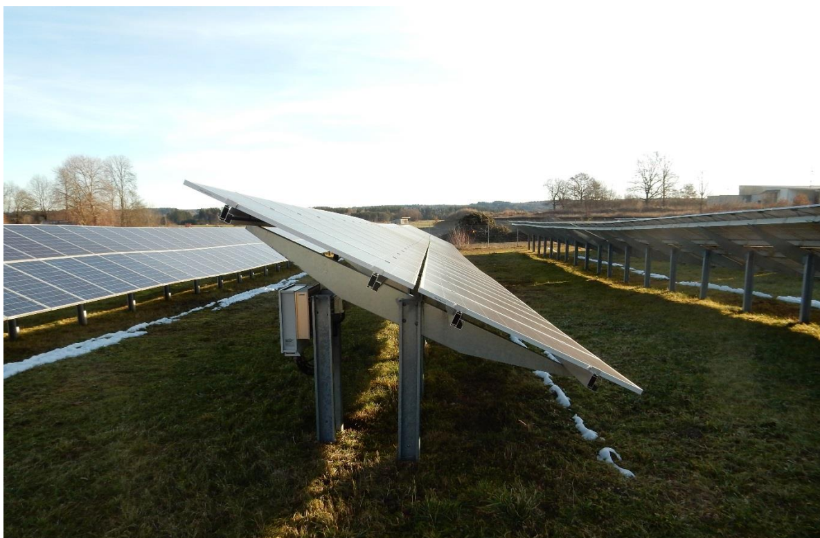
Abbildung 6: Beispiel für eine Freiflächenphotovoltaikanlage mit Süd-Ausrichtung (Gemeinde Fuchstal)
